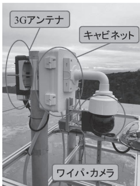
図-8 外部電源型観測装置の外観（山内撮影，2015/12/3）
