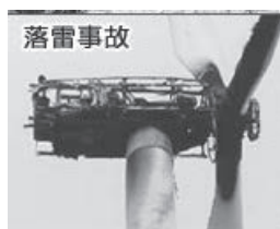
図-20 落雷により破壊された設備[39]
