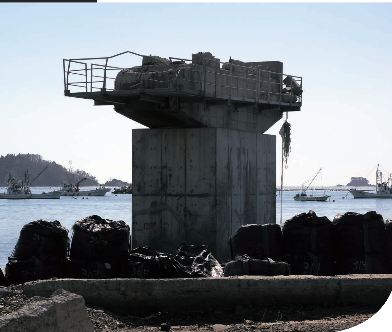
壊れた橋脚と湾にぎわう漁船 2013年3月南三陸町歌津にて撮影
